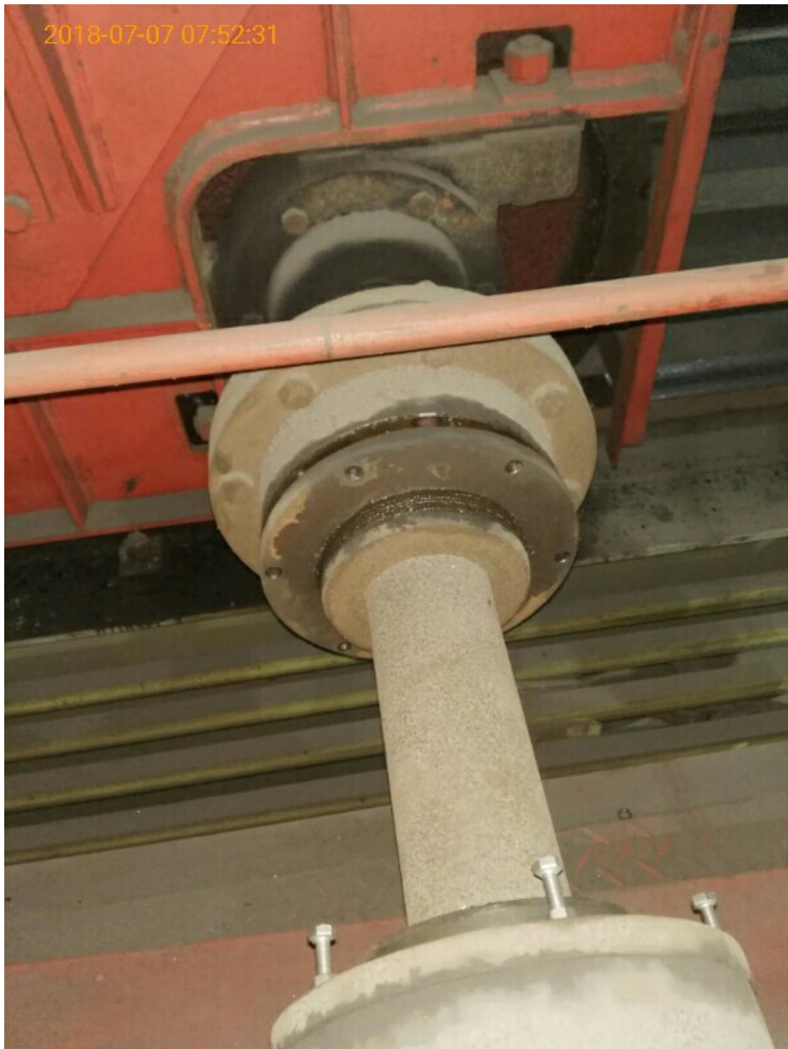
隐患排查中发现大车联轴器螺丝全部掉落
